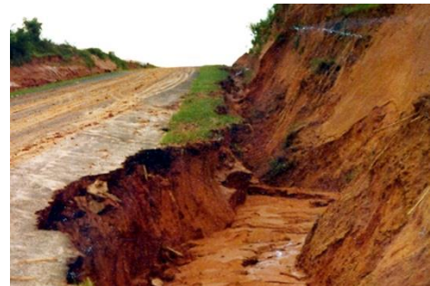
Figura 3.15 – Erosão na borda da base do pavimento
